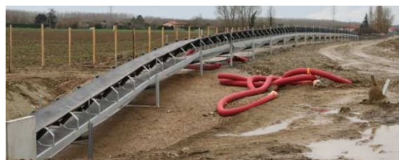
Bande transporteuse sur le site de Jullias, qui passe sous la RD6 entre Dieupentale et Verdun et au carrefour des chemins de la Fontaine et de Jullias.
