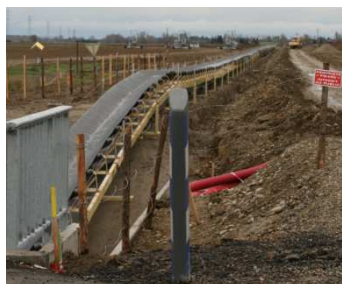
Bande transporteuse sur le site de Tanéria, qui passe sous la RD6 entre Dieupentale et Verdun
